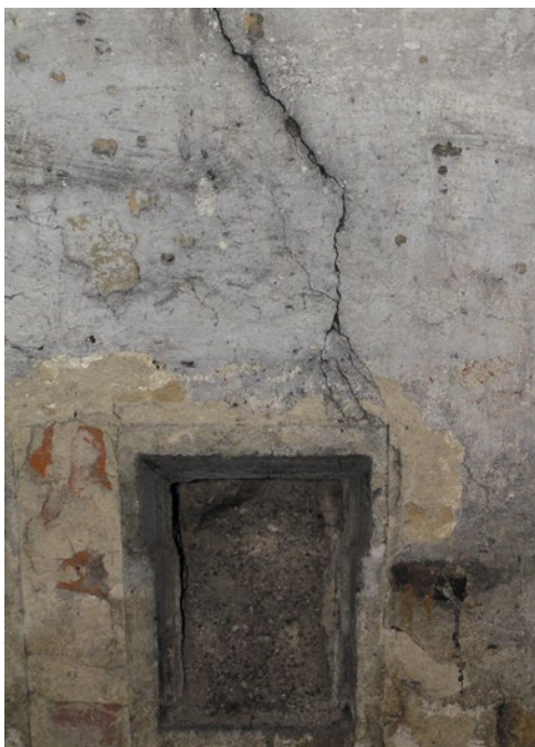
Obrázek 2.2 Trhlina v komínovém zdivu
