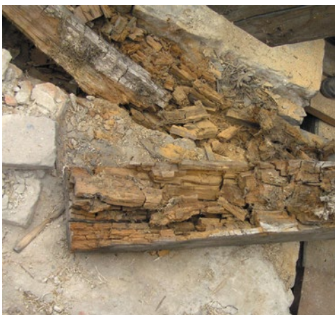
Obrázek 2.4 Biologická degradace dřevěného prvku
