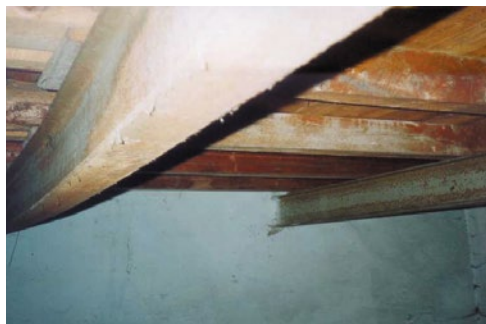
Obrázek 2.1 Nadměrný průhyb stropního trámu
