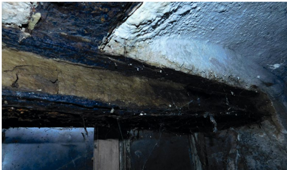
Obrázek 2.5 Pokročilá koroze ocelového nosného prvku strop
