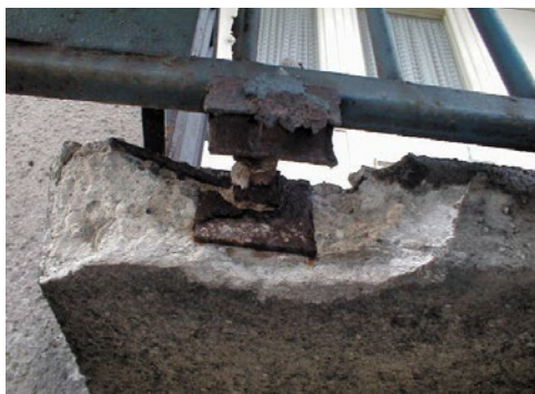
Obrázek 2.12 Zvětrání betonu a jeho odpadávání v důsledku povětrnostních vlivů
