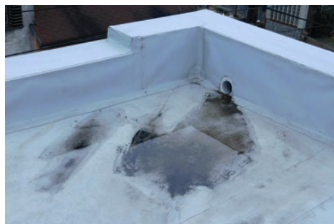
Obrázek 2.9 Vada zapříčiněná dodavatelem – neodborně provedená pokládka hydroizolační fólie
