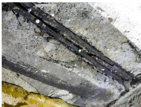
Obrázek 2.6 Pokročilá koroze výztuže železobetonu
