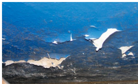
Obrázek 2.10 Odolupávání nátěru v důsledku vlhkosti zdiva (nátěr s vysokým difúzním odporem, který uzavřel v omítce nadměrné množství vody)
