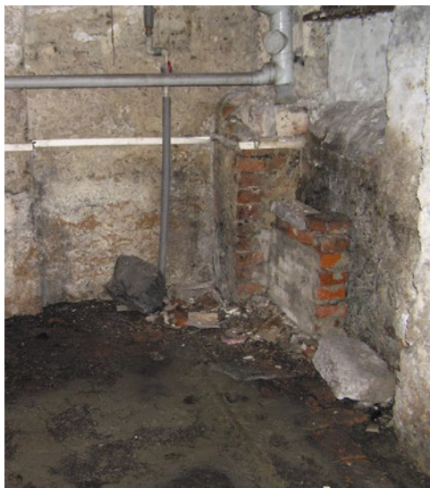
Obrázek 2.3 Průsak vody do suterénu
