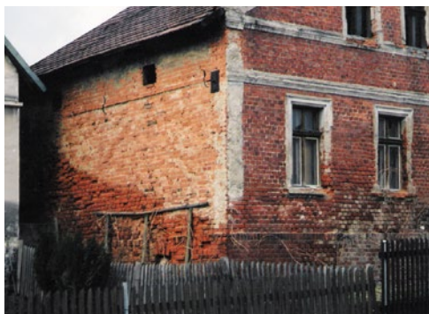
Obrázek 2.11 Zvětrání cihelného zdiva následkem povětrnostních vlivů
