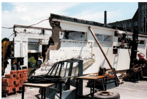
Obrázek 2.14 Destrukce objektu v důsledku výbuchu plynu
