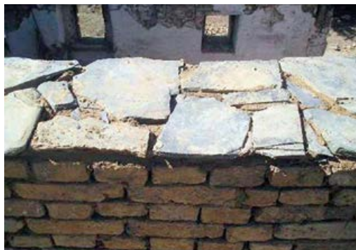
Obrázek 1.2 Břidličné desky jako jednoduchý způsob hydroizolace historického zdiva
