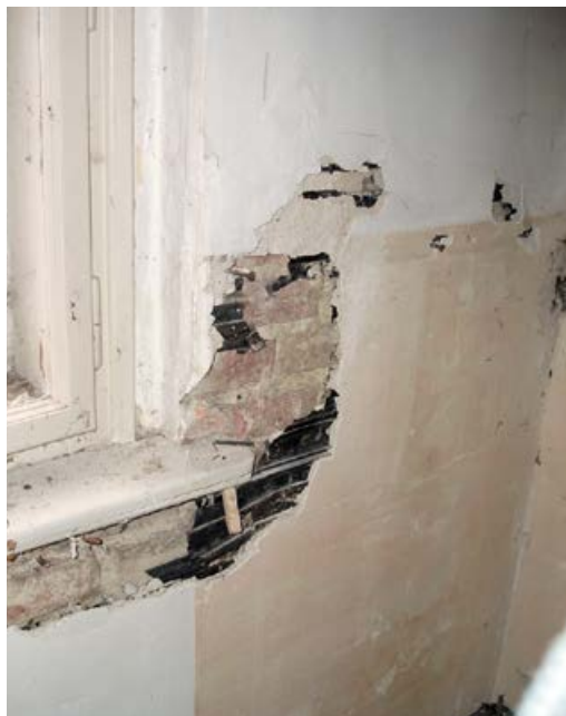
Obrázek 1.5 Způsob provedení vnitřní asfaltové izolace s horizontálními vzduchovými kanálky (první polovina 20. století)
