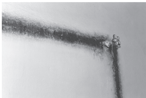
Obr. 1.5 Typickým projevem povrchové kondenzace je orosování povrchů konstrukcí, v tomto případě „obkreslování“ rozvodů studené vody s následným výskytem plísně
