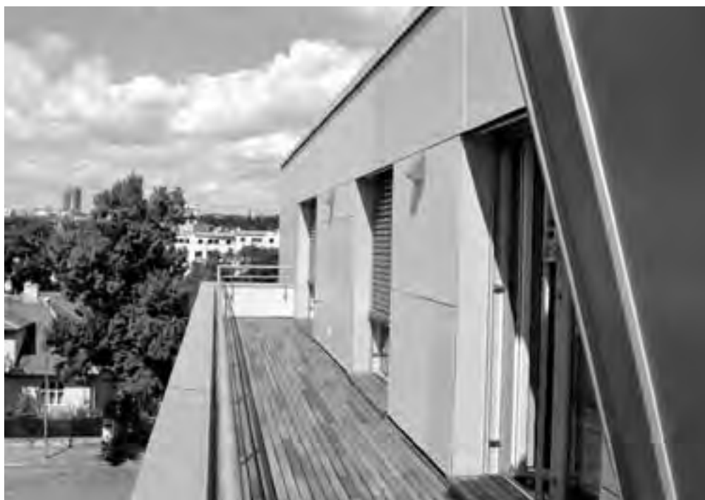
Obr. 17 Povrch fasády s obkladem cementovláknitými deskami je zavěšen na kotvy z laminátových profilů s podložkami Compactfoam s omezením tepelné vazby
