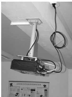
Obrázek 1.9: Projektor zavěšený u stropu
