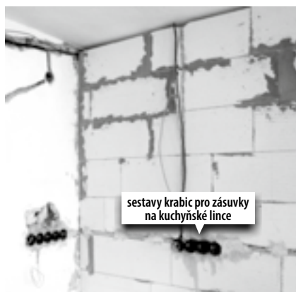
Obr. 4 Další část elektrické instalace v kuchyni
