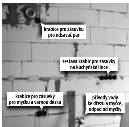
Obr. 3 Pohled na část elektrické instalace pro kuchyňskou linku
