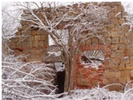
Část rozpadající se usedlosti Nový Dvůr
