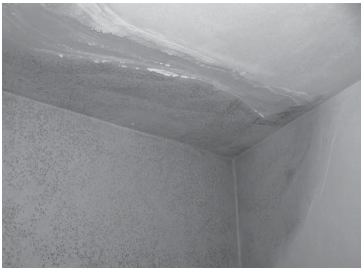
Obr. 10 Kondenzace vodní páry v koutě na povrchu stěny a stropu (nedostatečná tepelná izolace obvodové stěny)
