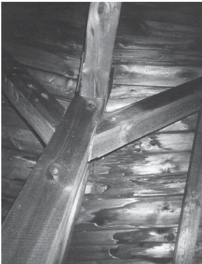
Obr. 2 Nadměrná vlhkost dřevěného bednění šikmé střechy způsobená srážkovou vodou v důsledku netěsnosti skládané střešní krytiny
