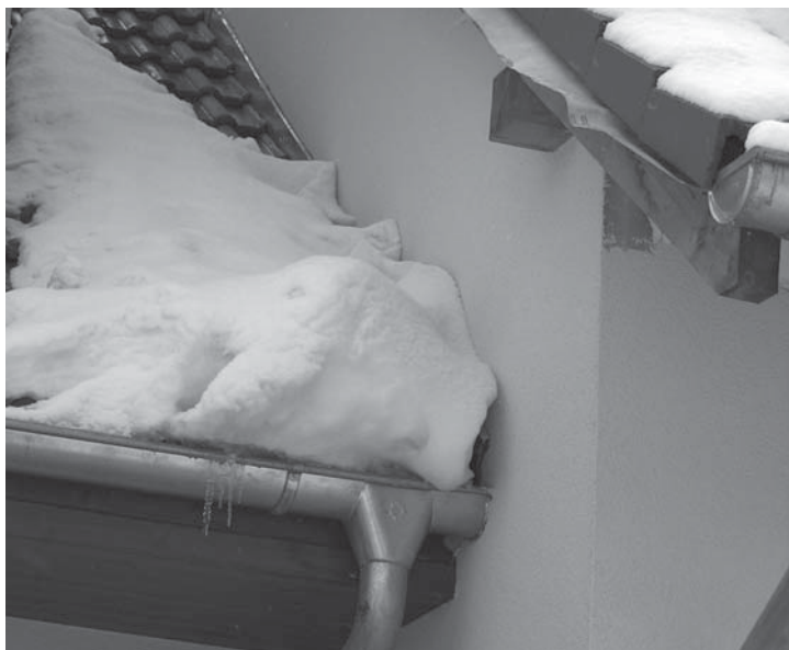
Obr. 3 Sníh, který přiléhá k obvodové stěně, může kvůli nedostatečné výšce plechového lemování způsobit její nadměrné zavlhčení. Pokud je lemování navíc provedeno chybně, při tání sněhu dojde k zatékání vody do střešního pláště
