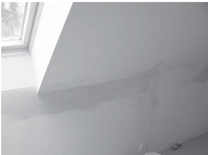
Obr. 11 Kondenzace vodní páry v místě obvodové stěny ze železobetonu
