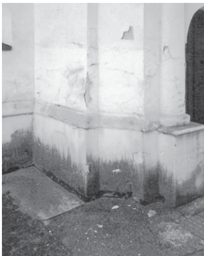
Obr. 5 Ukázka negativního vlivu srážkové vody na soklovou část objektu kostela – zamokření povrchu vodou
