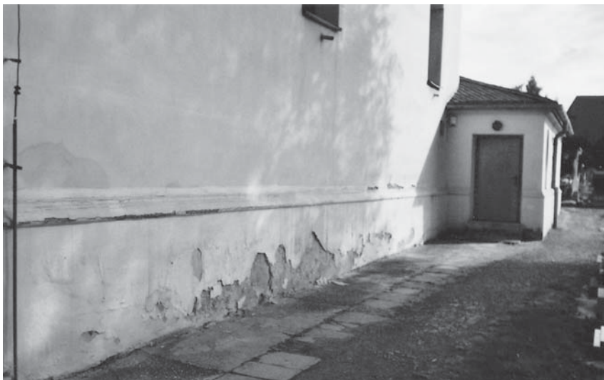
Obr. 4 Ukázka negativního vlivu srážkové vody na soklovou část objektu kostela – odpadnutá omítka
