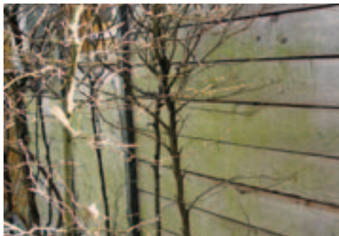
Obr. 2.11 Zeleň je v bezprostřední blízkosti dřevěné fasády. V důsledku husté vegetace se zvyšuje vzdušná vlhkost bezprostředně na fasádě. Zeleň poskytuje ochranu před větrem, ale zároveň omezuje proudění vzduchu, nezbytné pro vysychání fasády.
