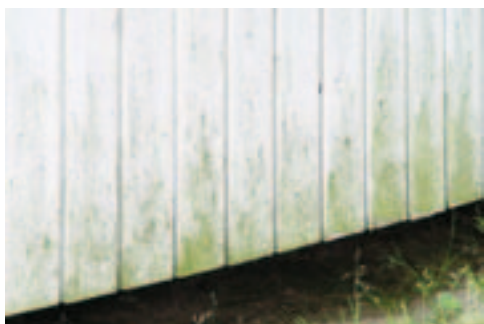
Obr. 2.12 Tvorba řas na vertikálně kladeném obložení na péro a drážku. Růst řas v oblasti soklu je důsledkem ostříkávání dešťové vody z kamenné desky. Štěrkové lože by množství ostříkující vody výrazně snížilo.
