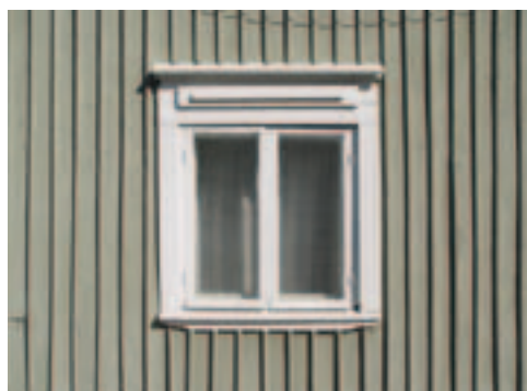
Obr. 1.7 V minulosti byly ozdobné prvky samozřejmostí. Avšak mnohé z těchto exponovaných dřevěných dílů se opotřebovávají. Vžilo se povědomí o nutnosti pravidelné údržby a eventuální výměny těchto dílů.
