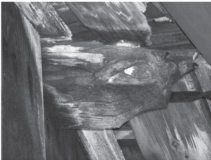
Obr. 4 Poškození krovu způsobené zatékáním po krokách
