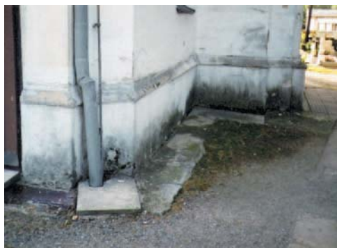
Obrázek 2.5 Nadměrné zavlhčení soklu následkem odšťikující vody a použití nevhodného fasádního nátěru v místě soklu. Chybné napojení dešťového odpadu
