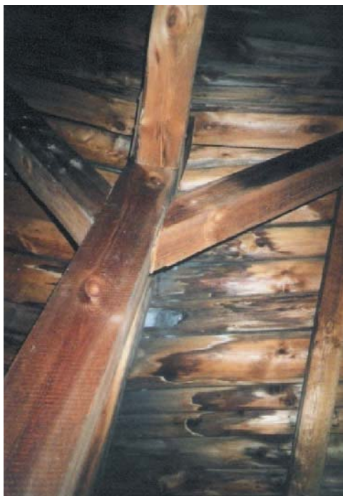
Obrázek 2.12 Napadení dřevěného bednění střechy hnilobou v důsledku zatékání dešťové vody
