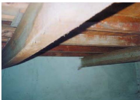
Obrázek 2.1 Nadměrný průhyb stropního trámu
