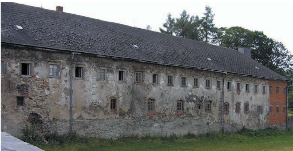
Obrázek 2.15 až 2.18 Příklady poruch způsobených opotřebením materiálu a stárnutím, resp. zanedbanou údržbou
