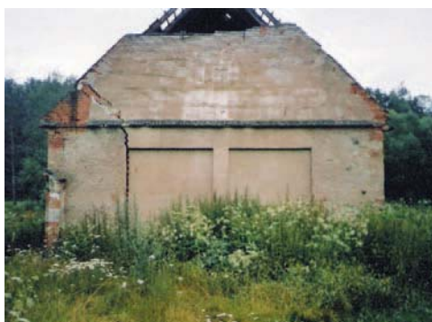
Obrázek 2.10 Trhlina ve zdivu vzniklá v důsledku podmáčení základů vodou z povodňové vlny
