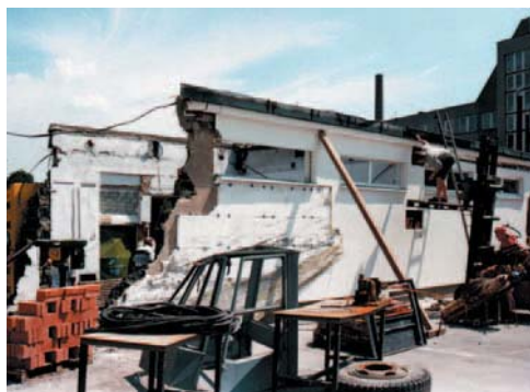
Obrázek 2.13 Destrukce objektu následkem výbuchu plynu
