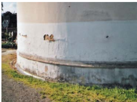
Obrázek 2.6 Odpadávání omítky v důsledku aplikace nevhodného fasádního nátěru (akrylátový nátěr s vysokým difúzním odporem, který uzavřel v omítce nadměrné množství vody)
