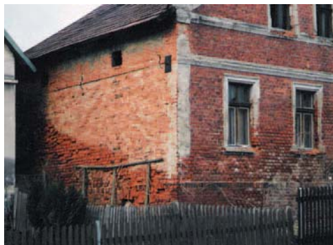
Obrázek 2.7 Zvětrání cihelného zdiva následkem povětrnostních vlivů
