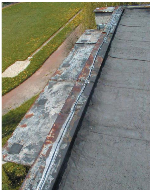
Obrázek 2.9 Korozí oplochování atiky zapříčiněná povětrnostními vlivy
