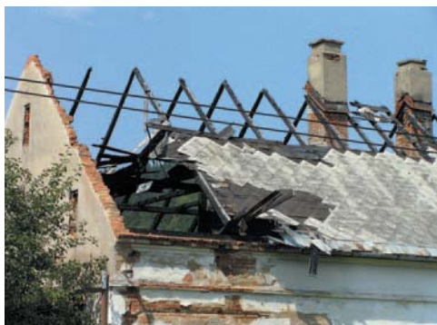
Obrázek 2.14 Destrukce objektu následkem požáru
