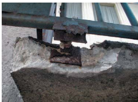
Obrázek 2.8 Zvětrání betonu a jeho odpadávání v důsledku povětrnostních vlivů
