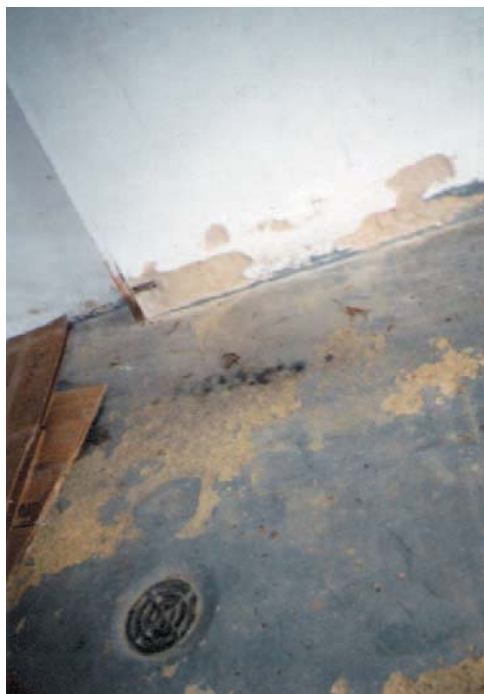
Obrázek 2.11 Destrukce omítky a nášlapné vrstvy podlahy v suterénu následkem zaplavení vodou uniklou z kanalizace
