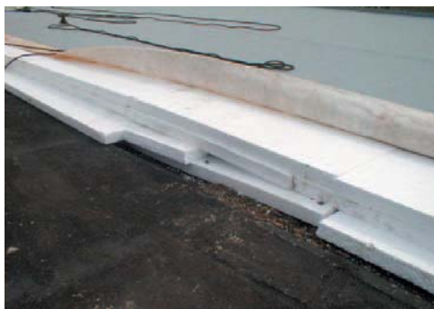
Obrázek 2.4 Závada zapříčiněná dodavatelem – nedbalé uložení tepelné izolace v ploché střeše
