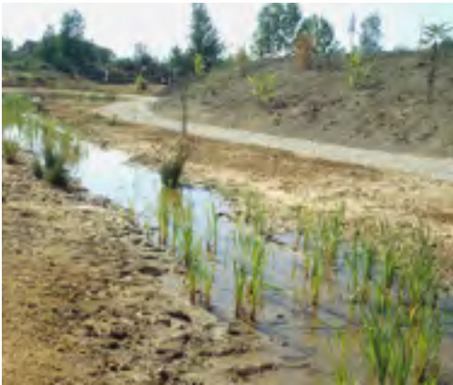
Obr. 3.1 Jílovitá půda se může použít jako plášť jezírka, pokud se zpevní vibračním kompaktozem. Přesto voda stěnou stále prosakuje
